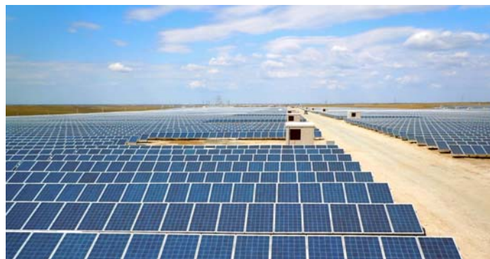
Рисунок 2.8 – Фотоелектрична сонячна станція
