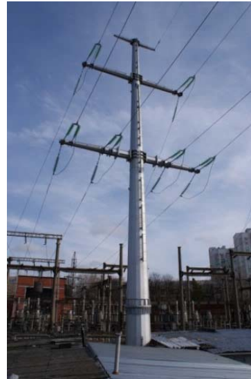
Рисунок 2.25 – Анкерна багатогранна металева опора лінії 110 кВ
