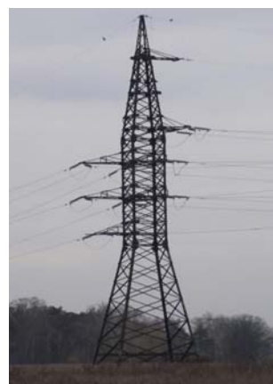
б) відпайкова опора лінії 110 кВ
