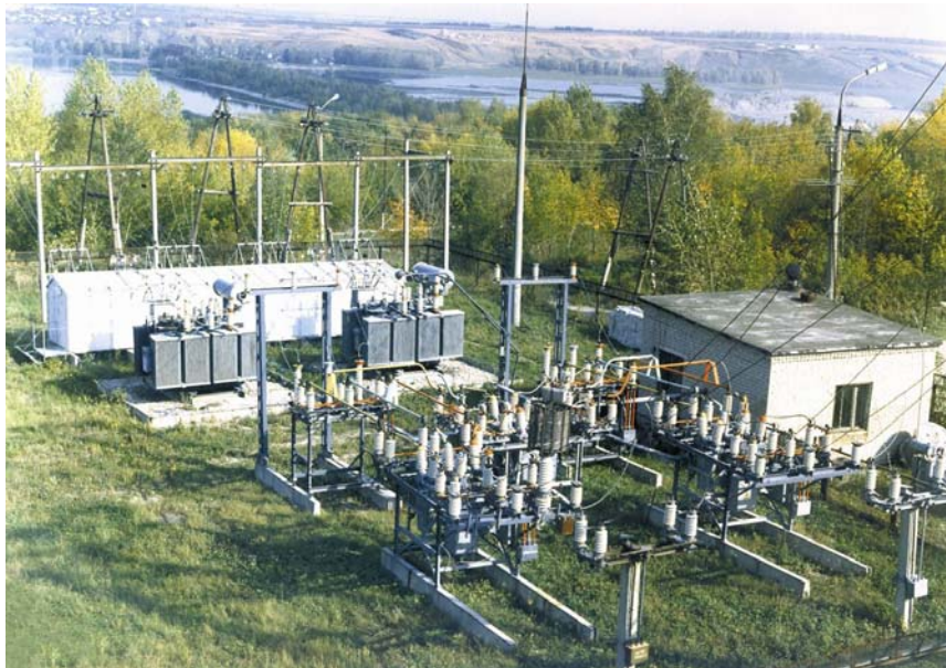
Рисунок 2.48 – Двотрансформаторна електрична підстанція 110/10 кВ відкритого типу
