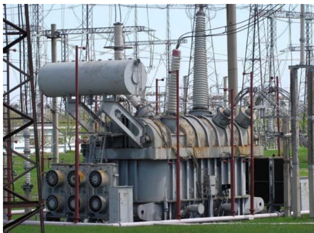
Рисунок 2.52 – Силовий автотрансформатор 750/330 кВ
